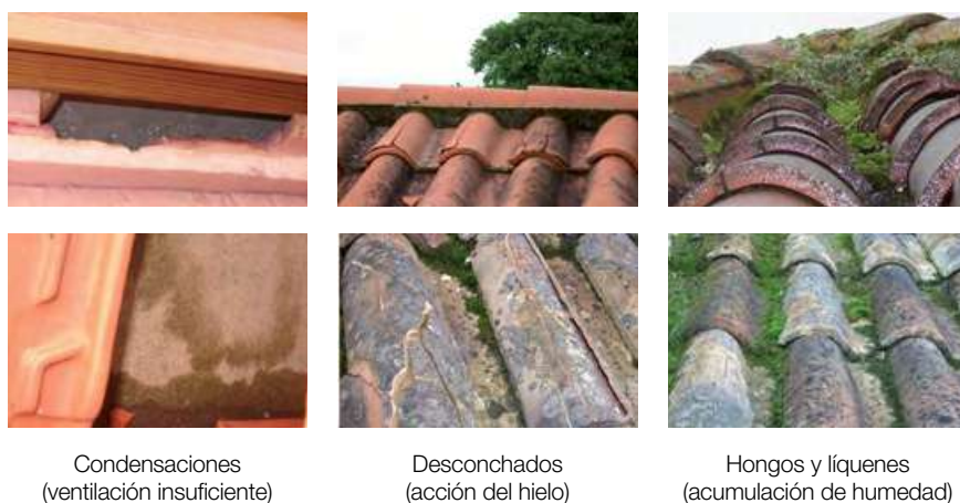
Figura 12. Posibles efectos adversos en cubiertas con tejas fijadas con mortero por falta de microventilación
