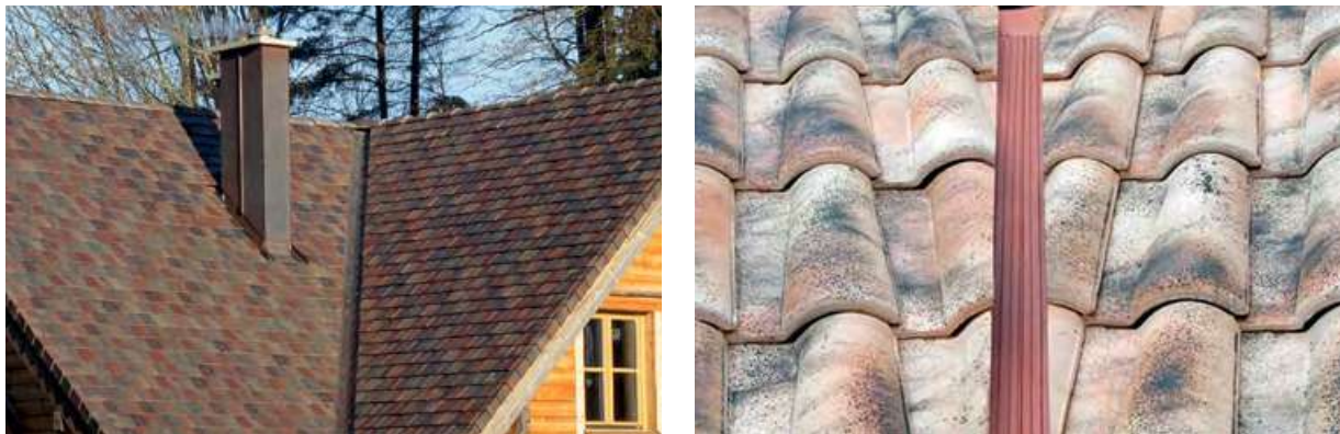
Figura 65. Limahoya libre para permitir la circulación de aire de la microventilación (entrada de aire por la parte baja y salida por la parte alta)
